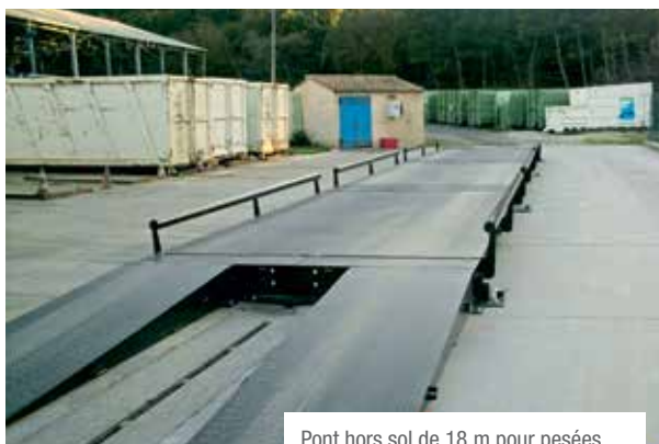
Pont hors sol de 18 m pour pesées des semi-remorques FMA
